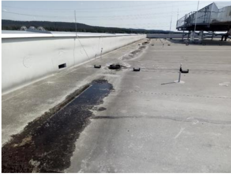
Abbildung 12 Fehlendes Gefälle zur Dachentwässerung (eigene Aufnahme, 2019)
